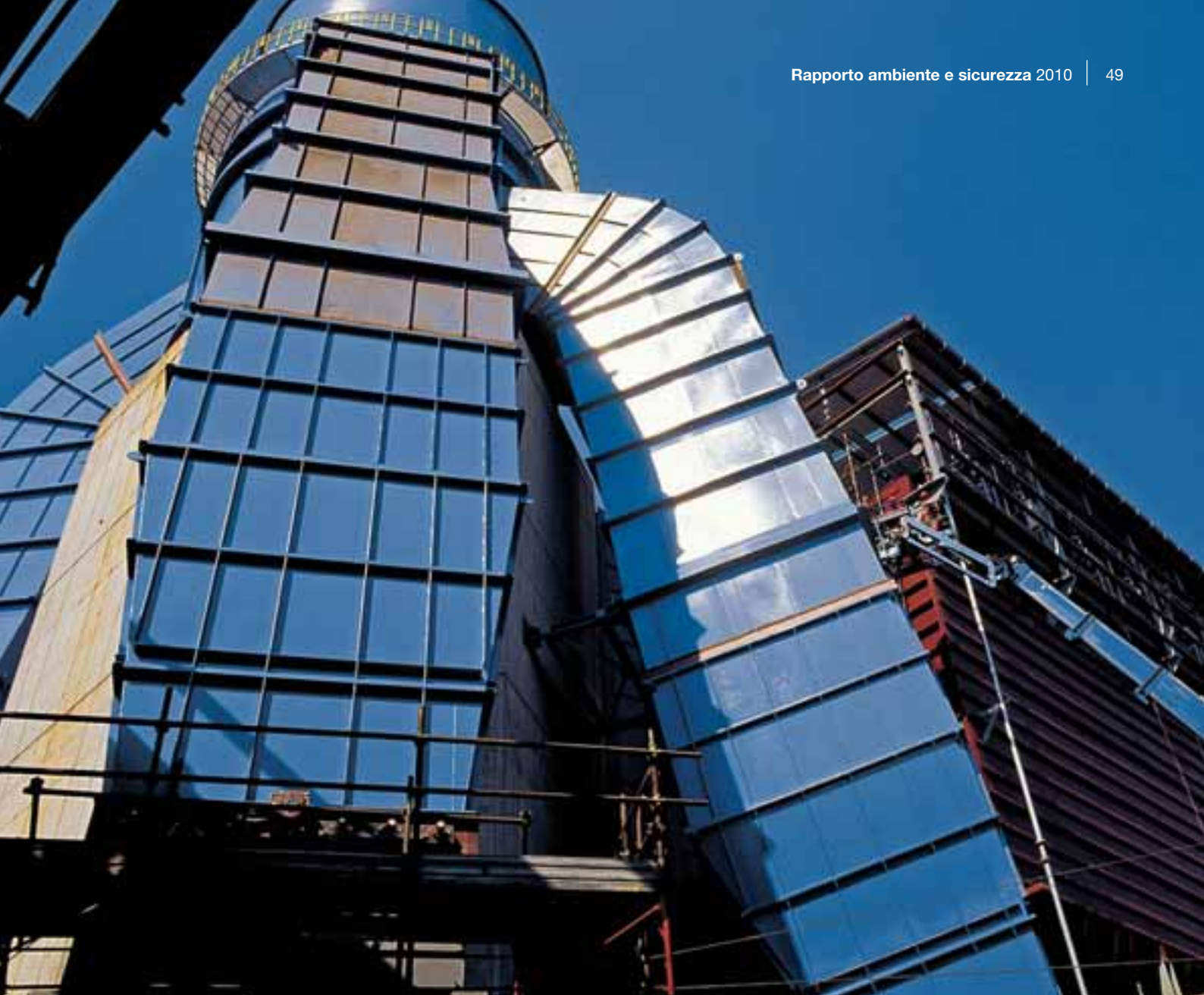
Figura 38 Foto impianto di aspirazione polveri ACC 2 (sezione ventilatori)
