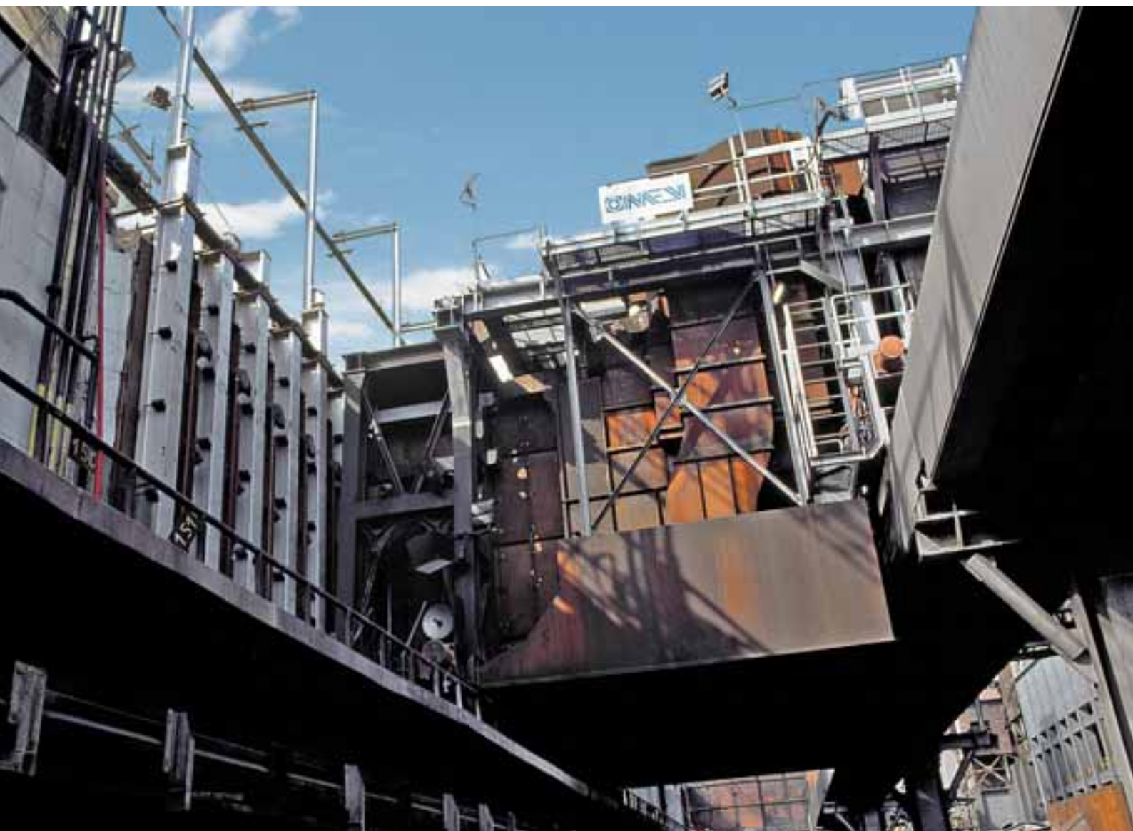
Figura 68 Impianto aspirazione fumi allo sfornamento del coke
