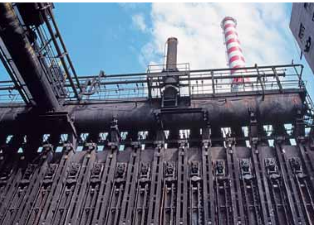
Figura 57 Batteria forni a coke
