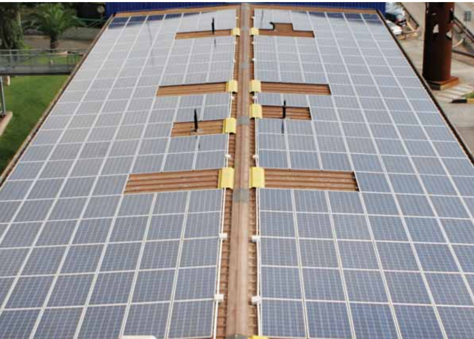
Figura 90 Pannelli fotovoltaici sulla palazzina Direzione
