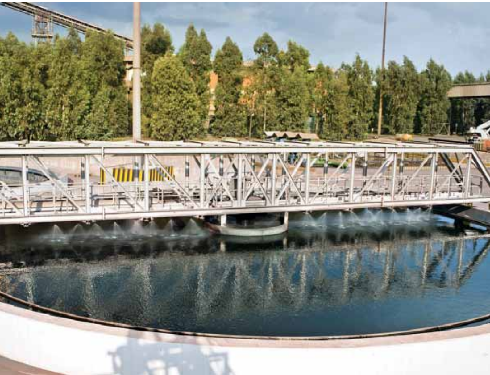
Figura 42 Foto dei chiarificatori
