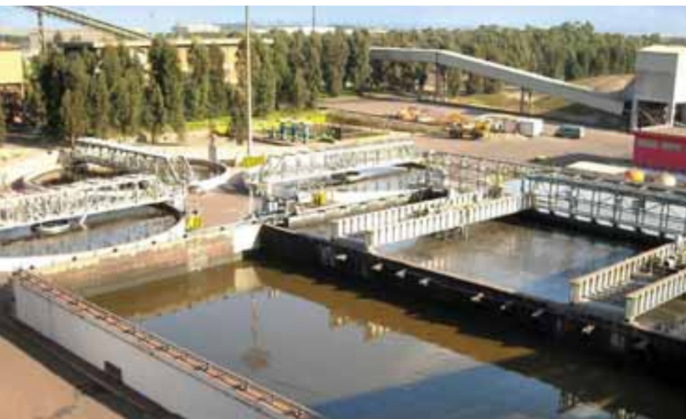
Figura 40 Vasca di aerazione
