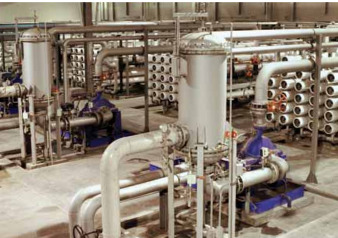
Figura 96 foto impianto di osmosi inversa
