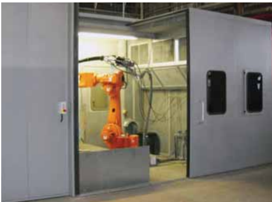
Figura 148 Officina Meccanica: impianto ricarica automatica per metallo bianco. Insonorizzazione del braccio automatico
