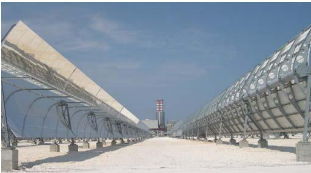
Foto 5: Impianto solare di cilindro parabolico
