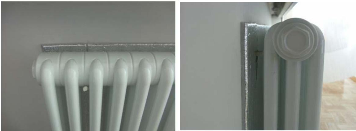
Fig. 7 – Pannelli isolanti termoriflettenti sul retro dei radiatori
