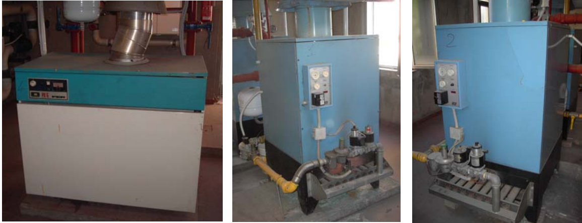
CALDAIE IN CENTRALE TERMICA
