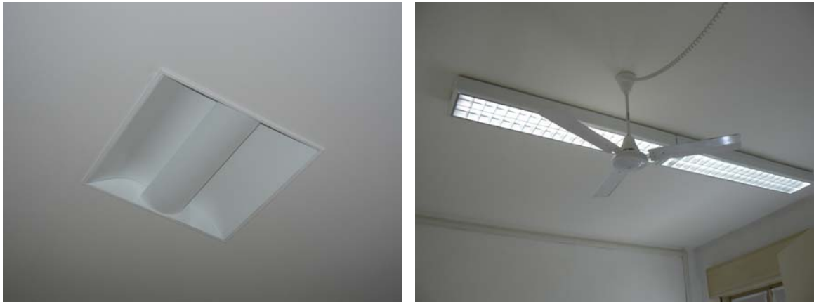
CORPI ILLUMINANTI NEI CORRIDOI (A SINISTRA) E NEGLI UFFICI (A DESTRA)
