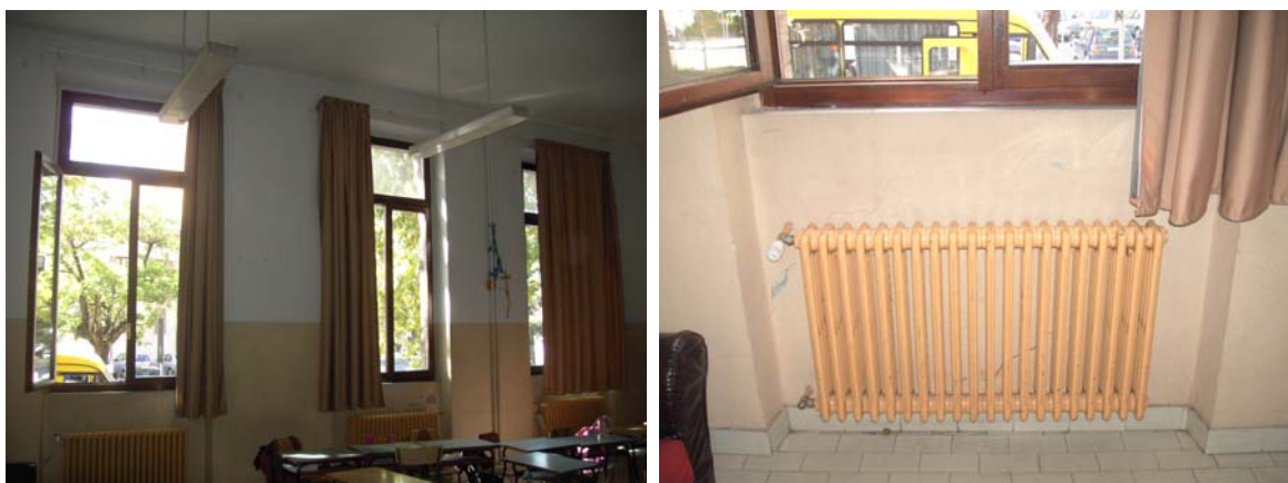
Fig. 6 – Parete di un'aula con radiatori nei sottofinestra
