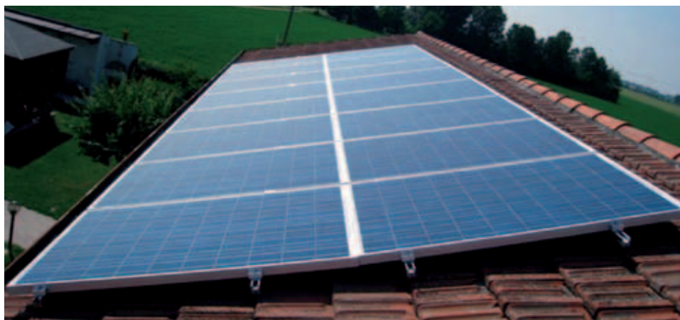
Impianto fotovoltaico su tetti, Comune di Alfonsine
