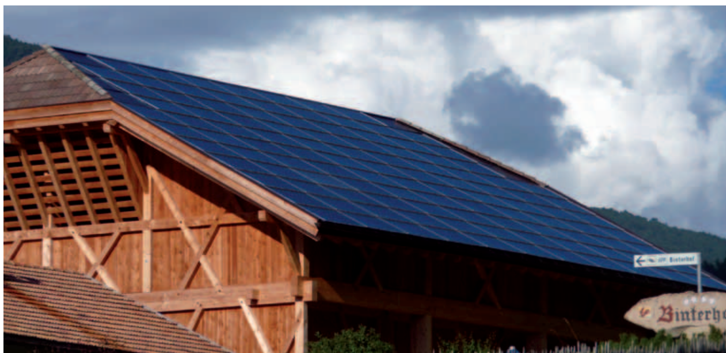
Impianto fotovoltaico su tetto
