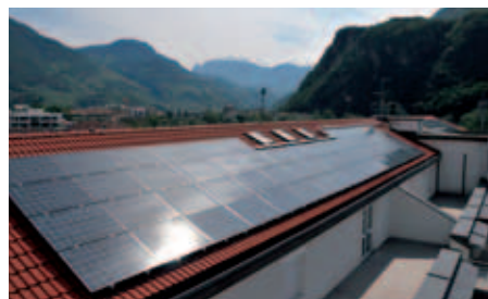
Impianto fotovoltaico su tetto della scuola Leonardo da Vinci, Comune di Bolzano
