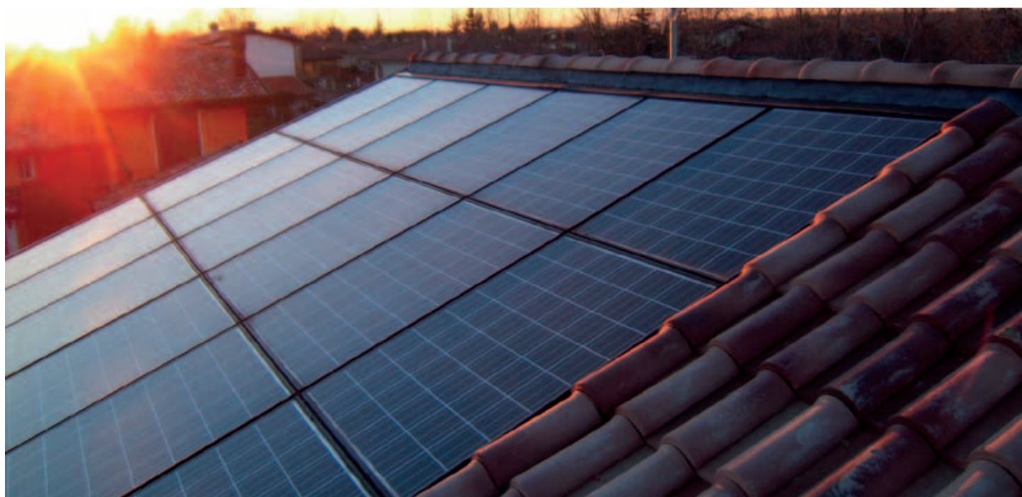
Impianto fotovoltaico integrato nel tetto
