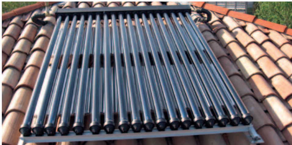
Impianto solare termico su tetto
