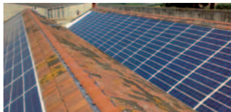
Impianto fotovoltaico a elettrotegola in ex masseria, Comune di Andria
