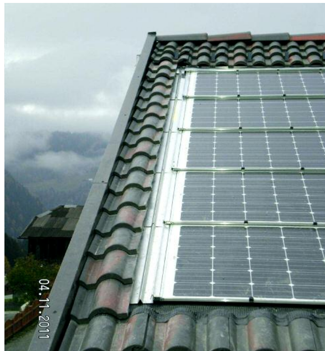
Ubicazione / Site Selva di Val Gardena (BZ) Potenza / Capacity 6 kW p
