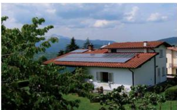
impianto a servizio di abitazione
