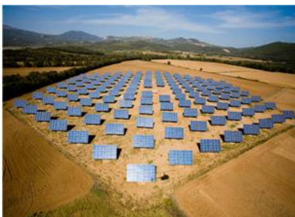
impianto a terra
