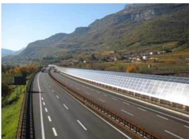
impianto su autostrada (barriera acustica)
