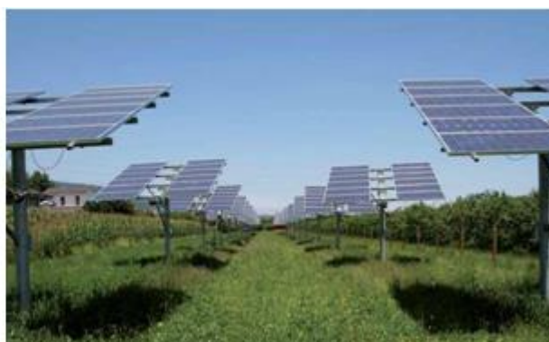
impianto ad inseguimento
