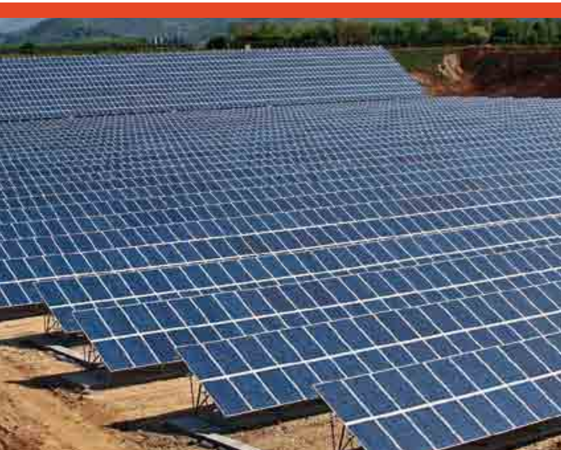
Parco fotovoltaico all'interno di ex cava a Premariacco (UD)
