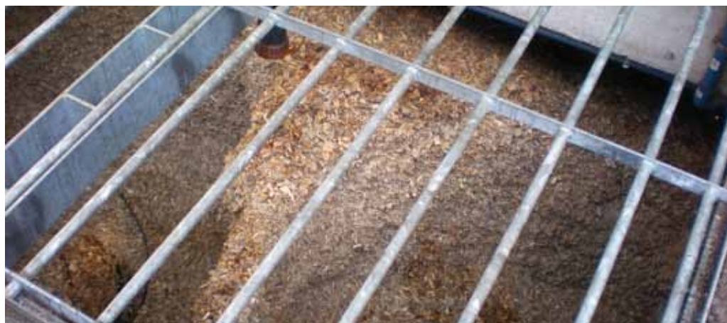
Vasca di raccoglimento del cippato del piccolo impianto a biomassa a Caldaro sulla Strada del Vino (BZ)
