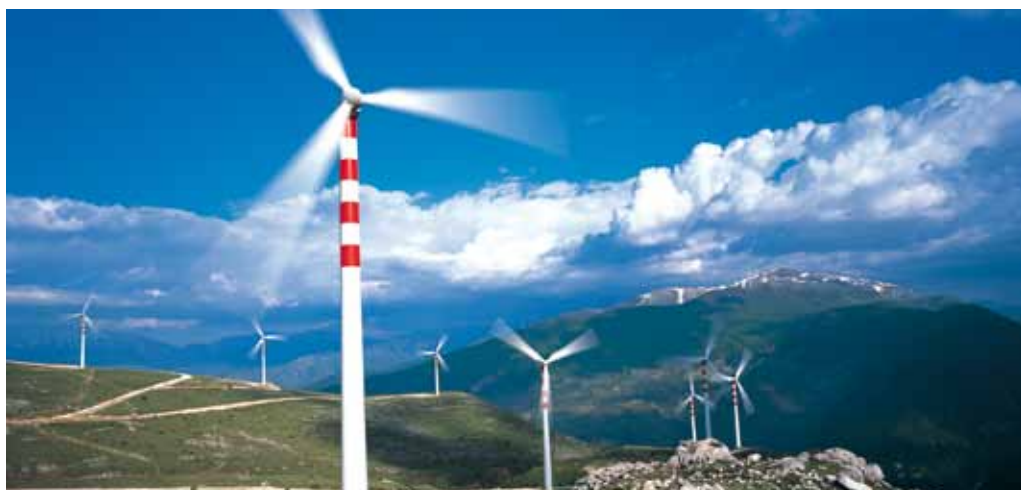
Impianto eolico Comune di Cocullo (AQ)
