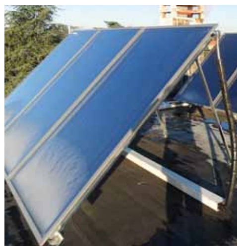
Impianto solare termico su copertura di una scuola, Comune di Piacenza
