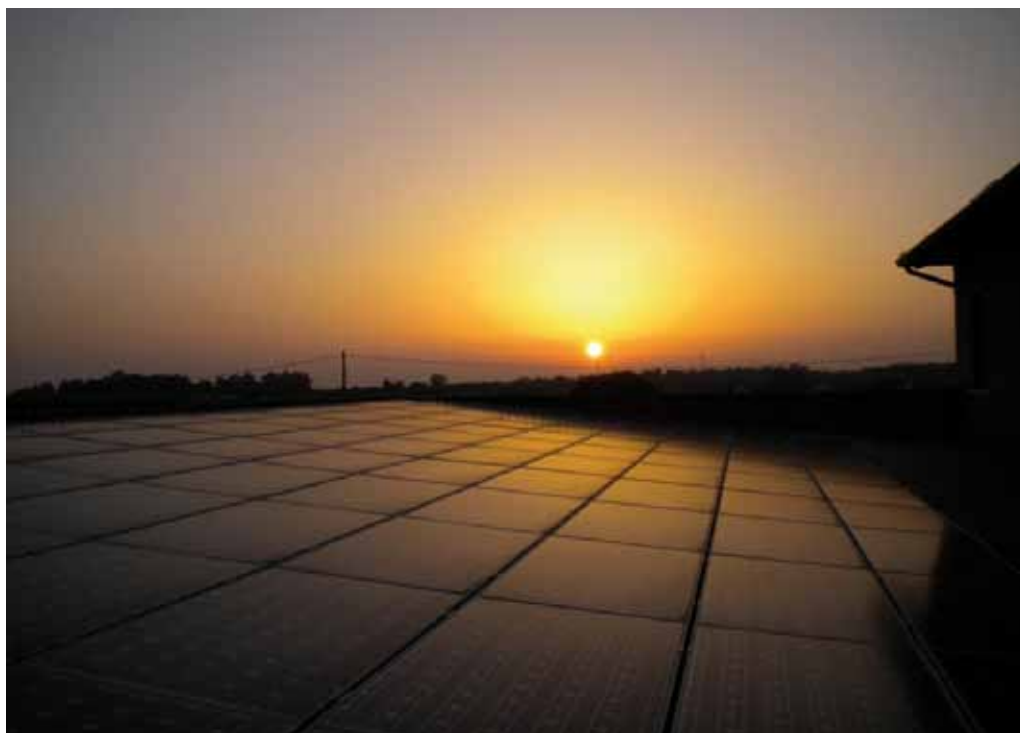
Impianto fotovoltaico Tenuta Menfi (AG)
