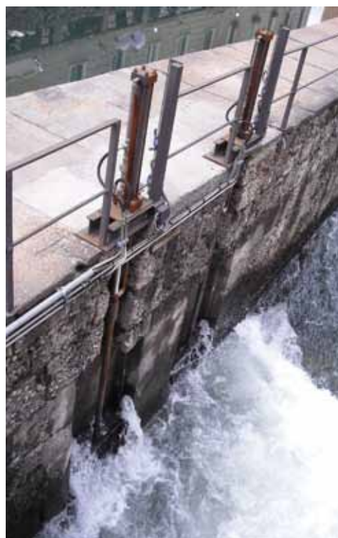
Impianto mini idroelettrico, Comune di Milano
