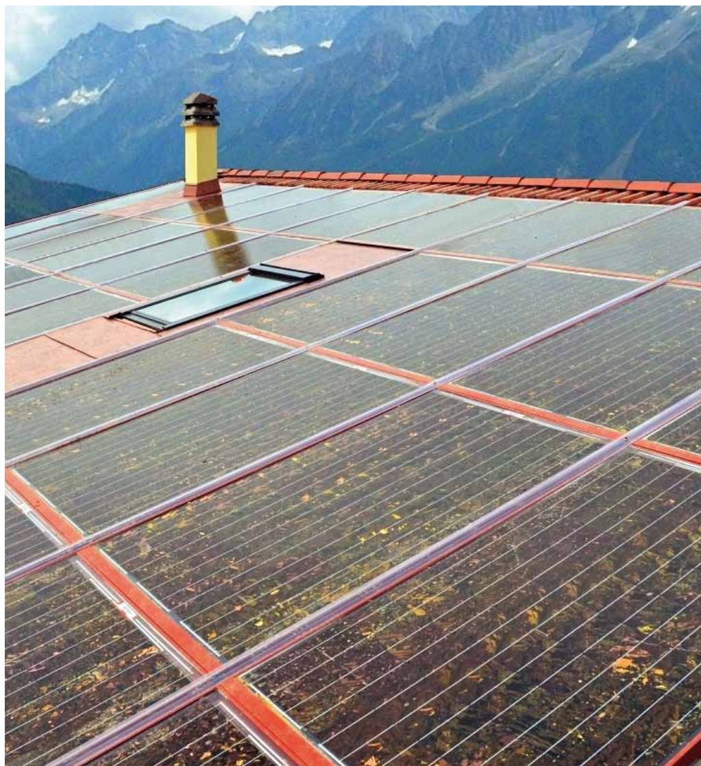
Impianto fotovoltaico su edificio privato adibito ad asilo, Comune di Curmo (BG)
