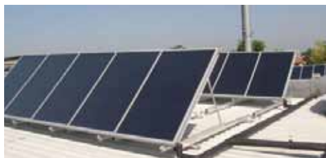
Impianto solare termico, Comune di Bra (CN)
