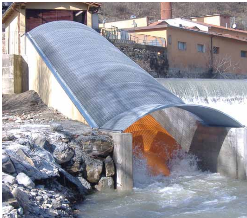
Impianto mini idroelettrico, Comune di Vaiano (PO)
