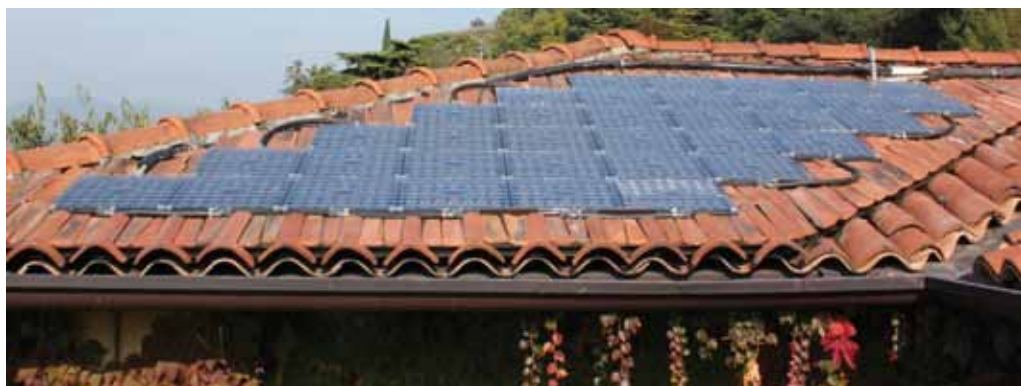
Impianto solare termico su tetto di un'abitazione privata, Comune di Vittorio Veneto (TV)
