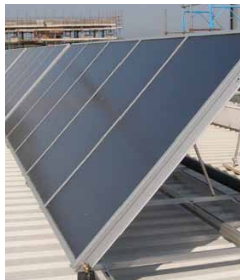
Impianto solare termico, Comune di Bra (CN)
