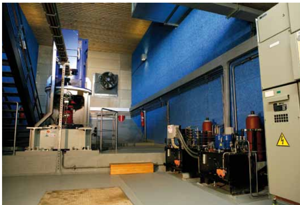
Impianto idroelettrico Envirometal Park (TO)
