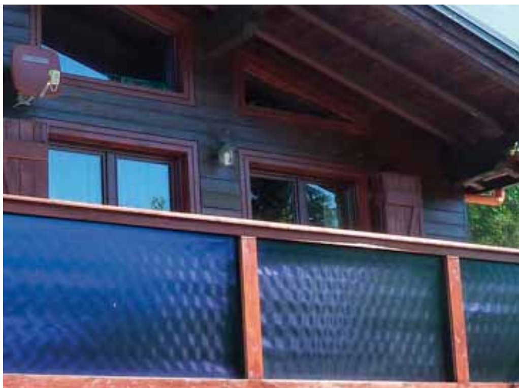
Impianto solare termico verticale, Comune di Forni di Zoldo (BL)
