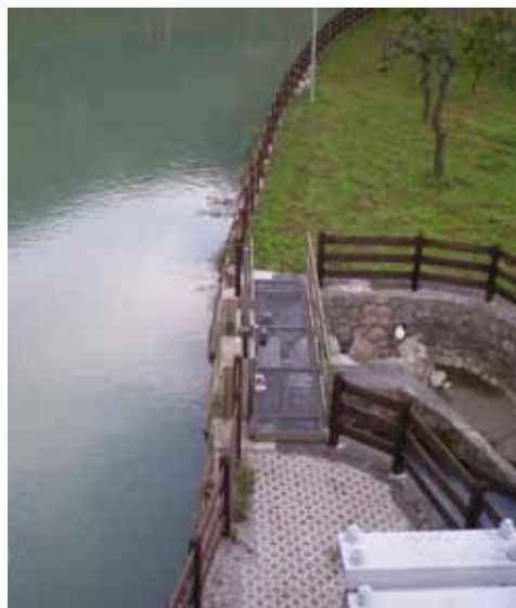
Impianto di risalita dei pesci della centrale idroelettrica "Claudio Castellani" nella Bassa Valle Isarco
