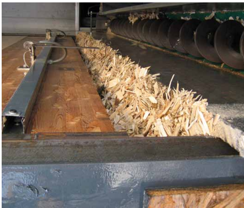
Impianto per lo sminuzzamento della biomassa solida
