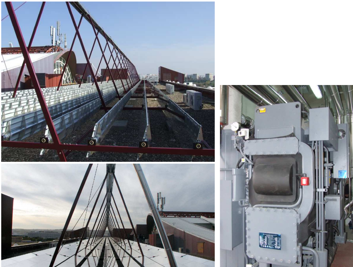
Figura 5.1 I collettori Fresnel installati presso l'università di Siviglia forniscono energia termica a un chiller a doppio effetto. In alto: gli specchi in posizione di riposo per evitare la stagnazione. In basso: gli specchi in fase di funzionamento. A destra: il chiller a doppio effetto. Fonte: AICIA, Siviglia (in alto e a destra), PSE, Germania (in basso)
