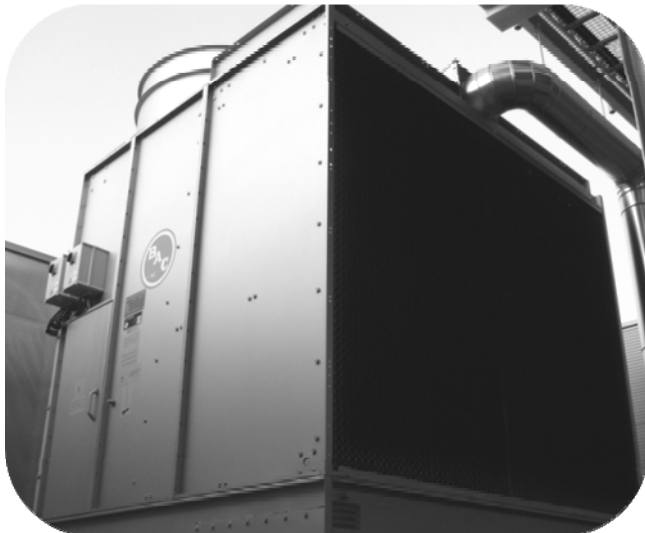
Figura 2.13 Esempio di una installazione a torre di raffreddamento umido di grandi dimensioni
