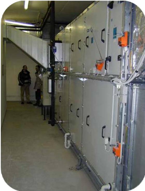
Figura 1.7 Unità centralizzata di trattamento dell'aria; l'aria è raffreddata con acqua fornita da macchine frigorifere.
